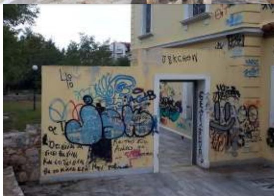
Απόψεις του «ελεύθερου» μαντρότοιχου, κάθετα στην ανατολική όψη του κτιρίου. Τα θυρόφυλλα του υπάρχοντος ανοίγματος έχουν καταστραφεί και αφαιρεθεί.
