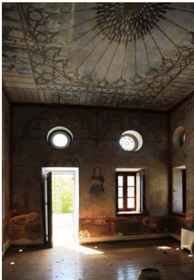
Αίθουσα Ν. Γύζη. Άποψη του νοτίου τοίχου. Απαιτείται συντήρηση και αποκατάσταση των τοιχογραφιών, των κουφωμάτων, του δαπέδου και της οροφograφίας.
