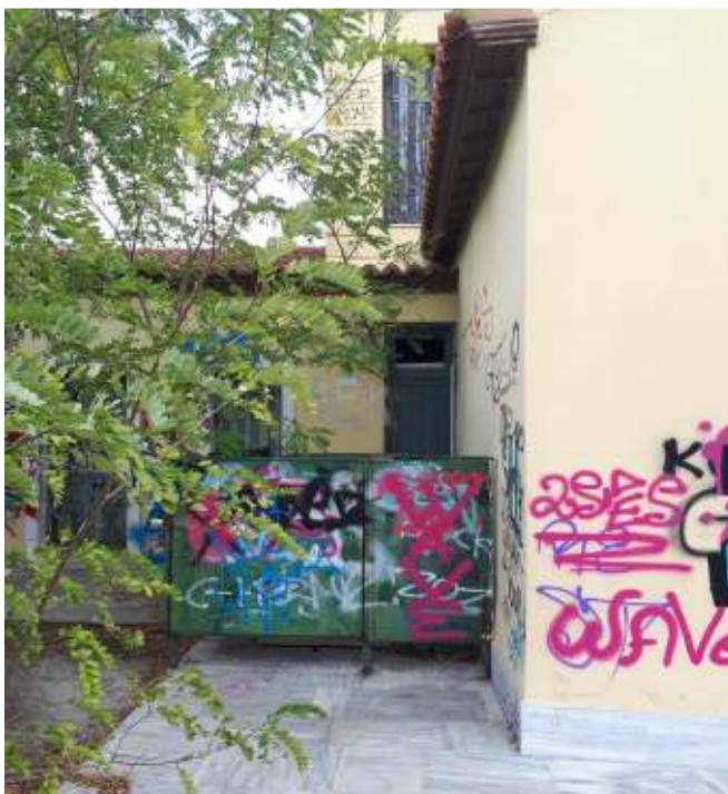
Λεπτομέρεια της δυτικής όψης. Χρειάζεται αποξήλωση της μεταλλικής δεξαμενής και αποκατάσταση της λειτουργίας της φραγμένης θύρας, που βρίσκεται όπισθεν της δεξαμενής.
