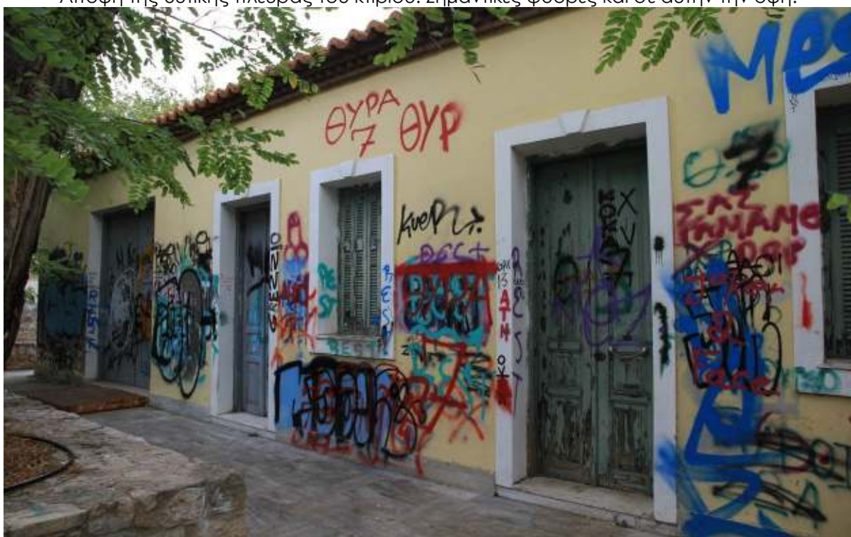
Άποψη του βορείου τμήματος της δυτικής πλευράς του κτιρίου με σημαντικές φθορές.
