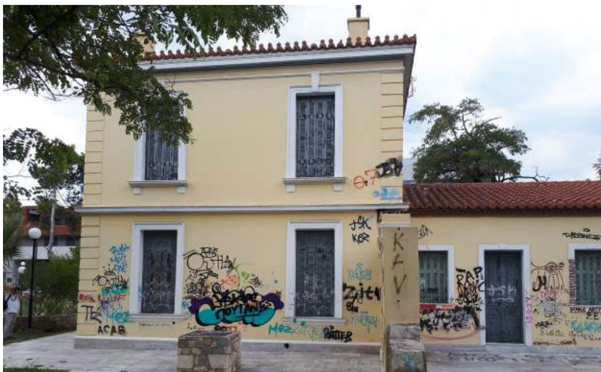
Ανατολική άποψη του κτιρίου. Η φθορές είναι εμφανείς.
