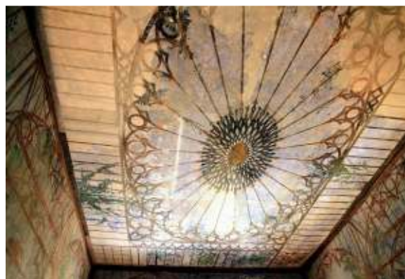
Αίθουσα Ν. Γύζη. Άποψη της οροφograφίας. Απαιτείται συντήρηση και αποκατάσταση της.
