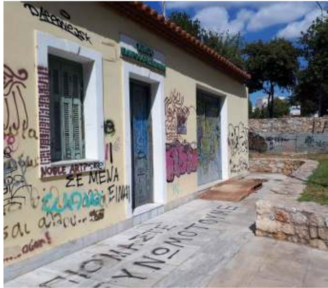
Άποψη της ανατολική όψης. Η μεταλλική ράμπα χρειάζεται αποξήλωση και ανακατασκευή με υλικά ίδια με αυτά του υπολοίπου εξωτερικού δαπέδου.
