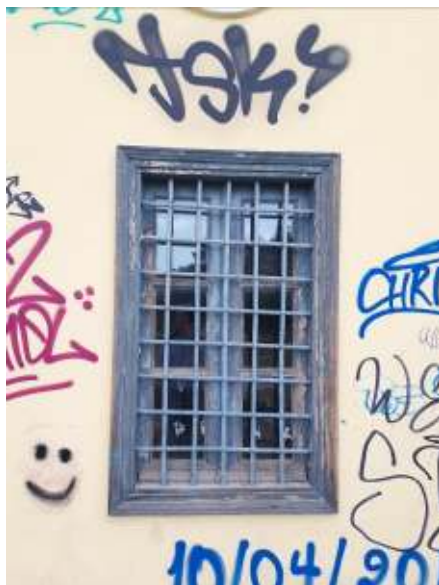
Άποψη παραθύρου της νότιας όψης της αίθουσας Ν. Γύζη. Απαιτείται συντήρηση και αποκατάσταση.
