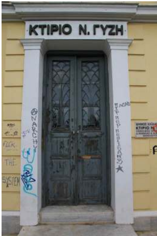
Άποψη της ισόγειας κεντρικής εισόδου. Το κούφωμα χρειάζεται συντήρηση και αποκατάσταση και η κακότεχνη επιγραφή στο υπέρθυρο αποξήλωση.
