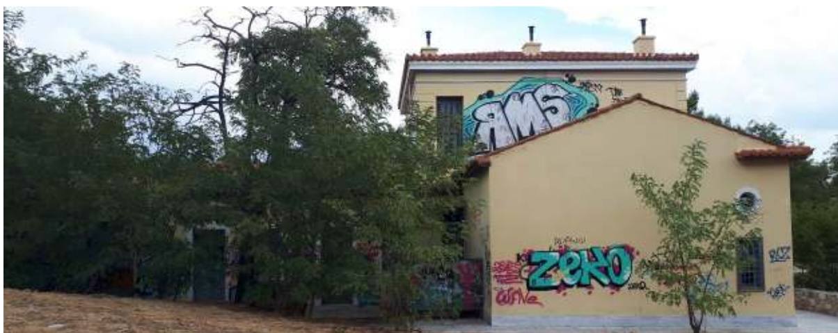
Άποψη της δυτικής πλευράς του κτιρίου. Σημαντικές φθορές και σε αυτήν την όψη.
