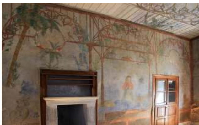
Αίθουσα Ν. Γύζη. Άποψη του ανατολικού τοίχου. Απαιτείται συντήρηση και αποκατάσταση των τοιχογραφιών, των ερμαρίων, του δαπέδου και της οροφograφίας.
