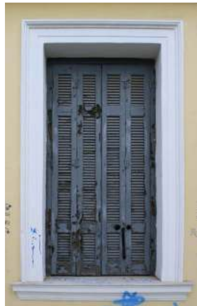
Άποψη τυπικού παραθύρου της νότιας όψης. Απαιτείται συντήρηση και αποκατάσταση.
